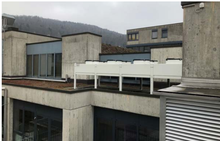
Abb. 21: Die Platzierung des Rückkühlgeräts heute (Foto: Planpartner AG)
