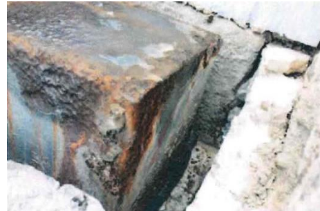
Hauptträger 7: Sehr geringe Korrosionsspuren auf der Oberfläche
